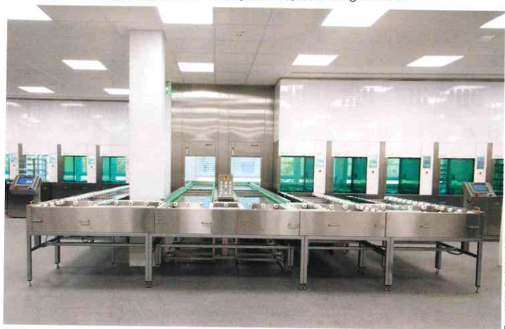
Convoyeur automatique de chargement/déchargement
