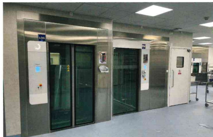
Mur technique de lavage automatisé
