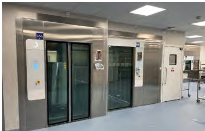
Mur technique de lavage automatisé
